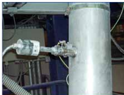
塑料颗粒流量测量 DN200 管道, 80 , 2T/h
