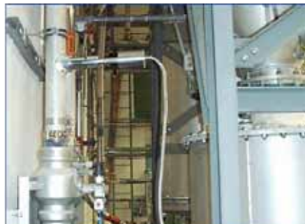
颜料粉末流量 (气力输送) DN50 管道, 70 , 2-5T/h
