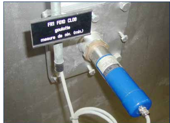
120 粉尘料位检测（隔离安装）
