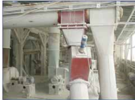
矿粉落料管堵料检测 (螺旋给料器)
