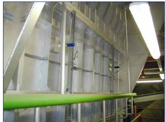
垃圾电厂燃料仓料位检测（多点测量）
