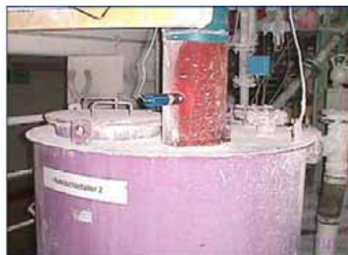
石灰粉落料管堵料检测
