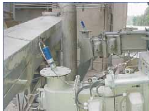
水泥厂生料堵料检测 (气力输送)
