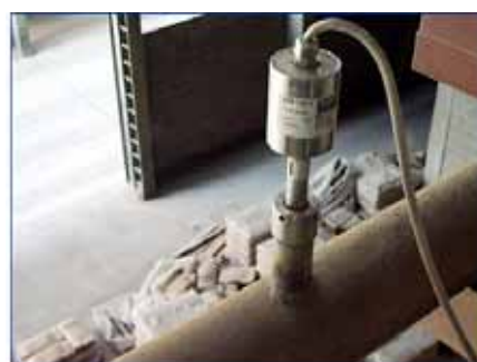
水泥厂粉尘流量 (气力输送) DN150 管道, 100 , 2-10T/h
